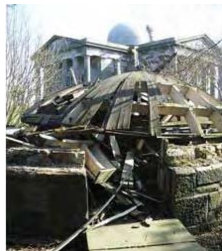
Collapsed Tweedie Dome
